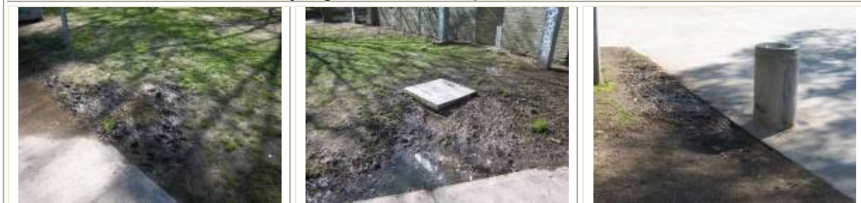
Foto N° 80 a 82. Sistema de riego deteriorado con aspersor a la vista y pérdida de agua; superficies anegadas por inadecuado drenaje.
